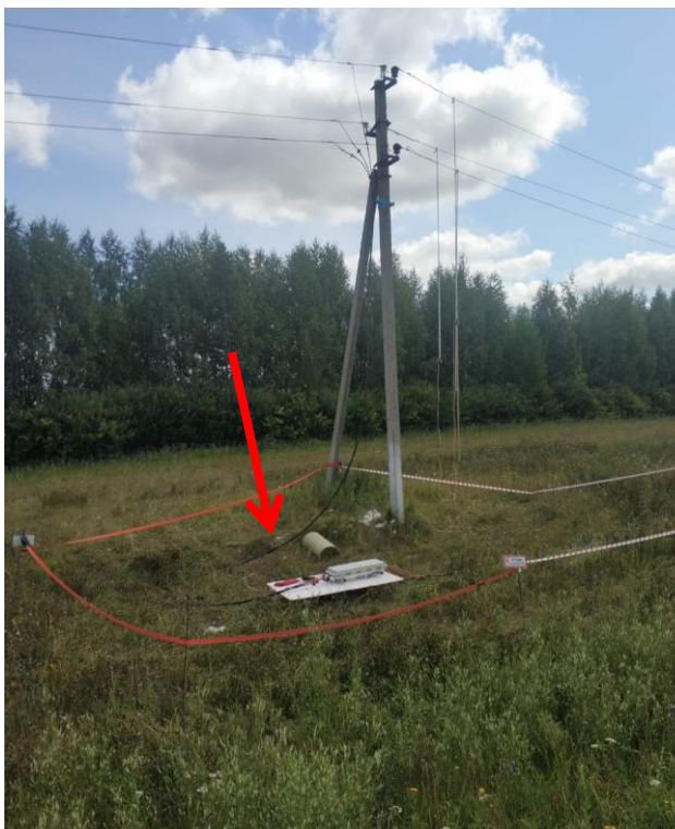
Комплекс сервисной линии СН, проложенный по земле
