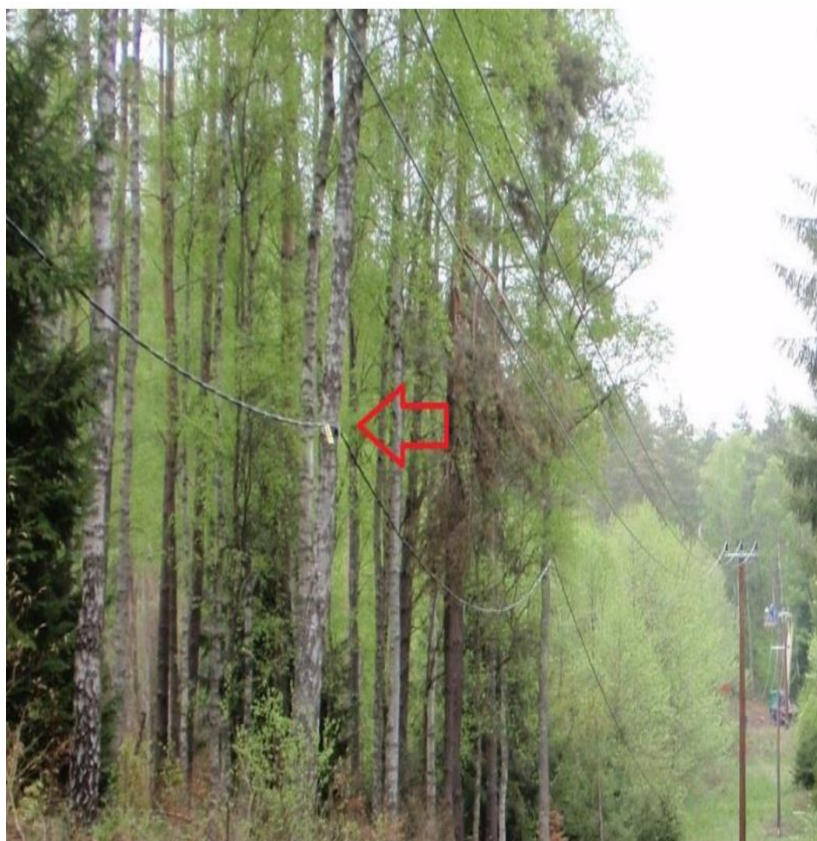
Комплекс сервисной воздушной линии СН, подвешенный на деревьях в лесу
